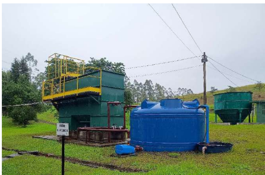
Figura 14 – Floccodcantador com capacidade de 10 m 3 /h– maio 2024.
