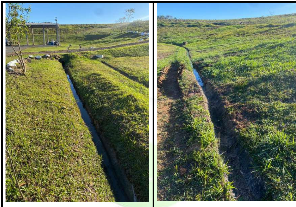
Figura 3: Sistema de drenagem de água pluvial.
