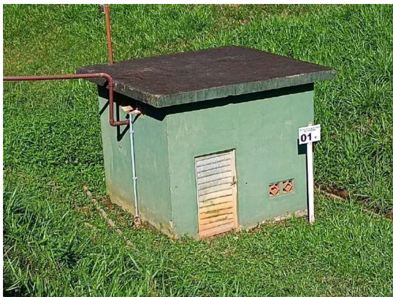
Figura 7: Sistema de bombeamento de lixiviado, maio de 2024.
