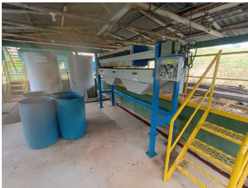
Figura 13 – Filtro Prensa e tanques adensadores da ETE – maio 2023.
