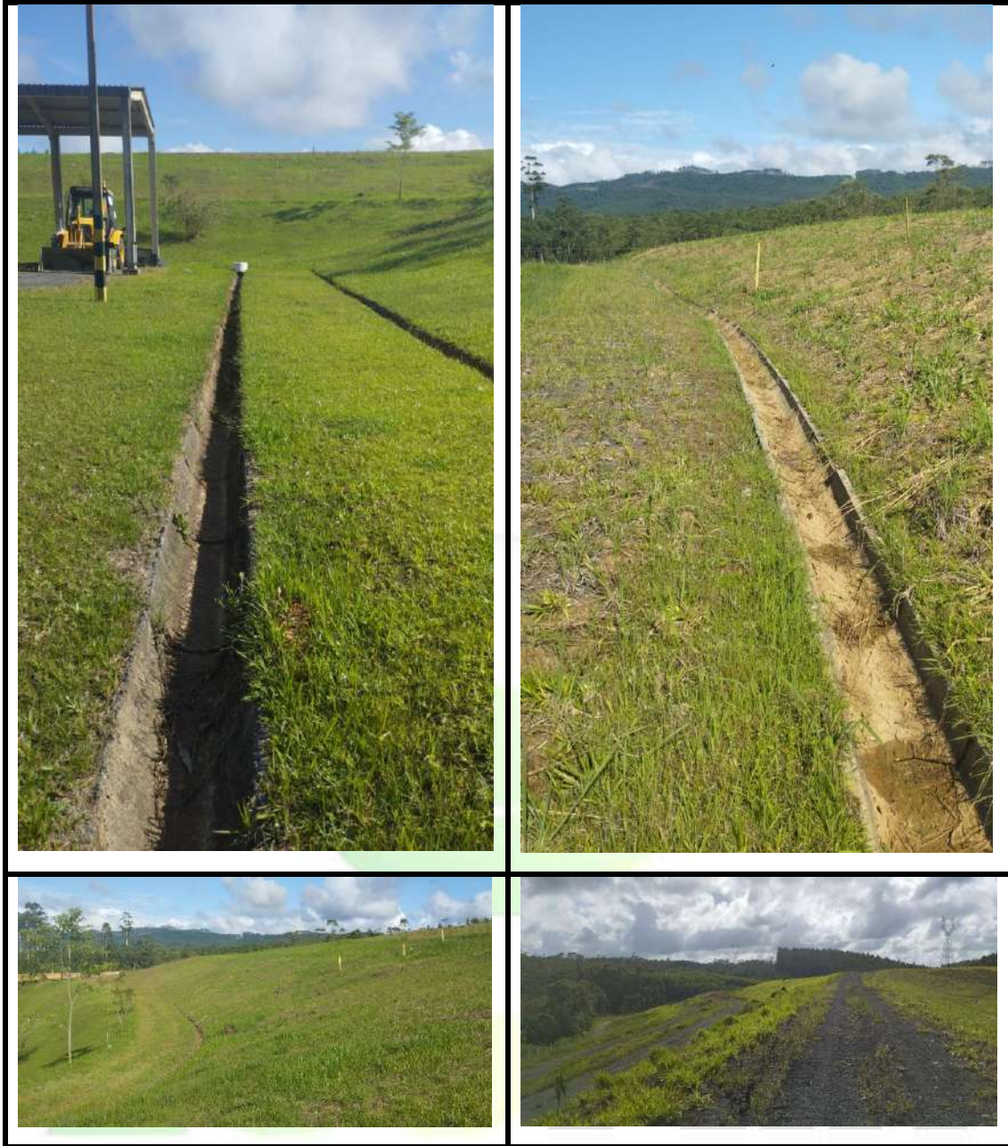
Figura 3: Sistemas de drenagem de água pluvial e a vegetação do talude.
